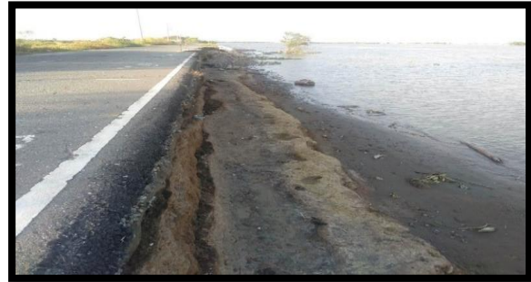
Figure-1: Actual Condition of the Sitio Delta, Consuelo Dike
